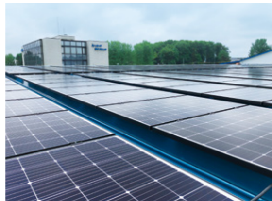
北上事業所事務棟の太陽光発電設備
