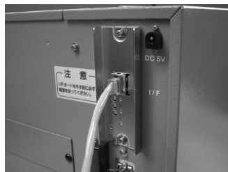
図 3.2 LAN ケーブル接続
