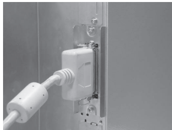
パラレルケーブル接続 (SG400R)
